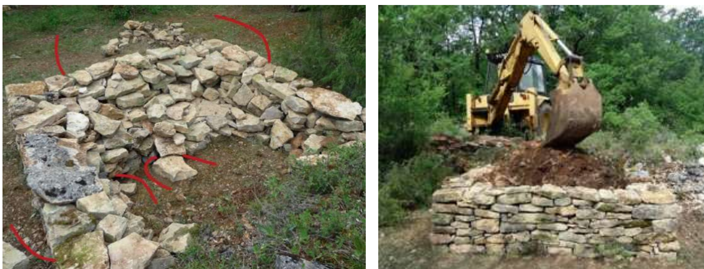
Figure 59 : Couverture de la galerie en pierres sèches (à gauche) ; Construction du dôme de terre (à droite) (ONCFS)
